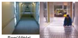
Repülőtéri beszállóalagút fűtése
